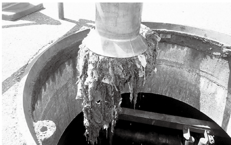
▲マンホールポンプに詰まった異物
