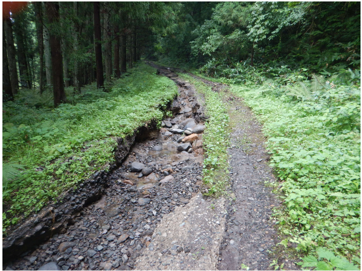
No.2 若林線 砂利流出 写真下側から
