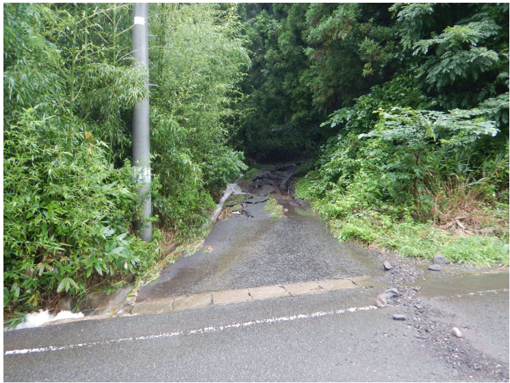
No.1 鹿野沢線 土砂流出 写真下側から
