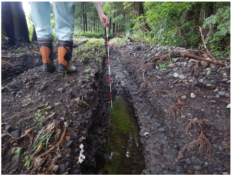
No.2 村上線 土砂流出 写真下側から
