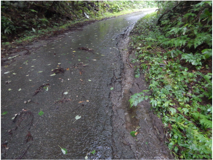
No.1 上小台線 舗装陥没 写真下側から
