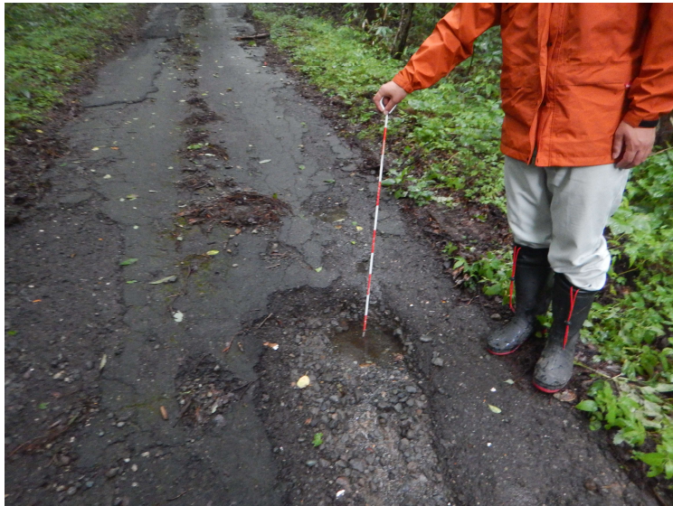
No.2 当山線 舗装陥没 写真下側から ..... ..... ..... ..... ..... ..... .....
