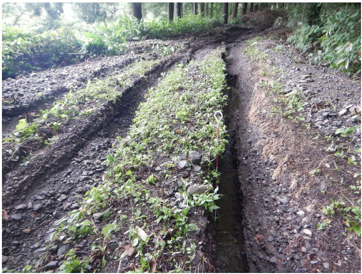
No.3 村上線 土砂流出 写真下側から
