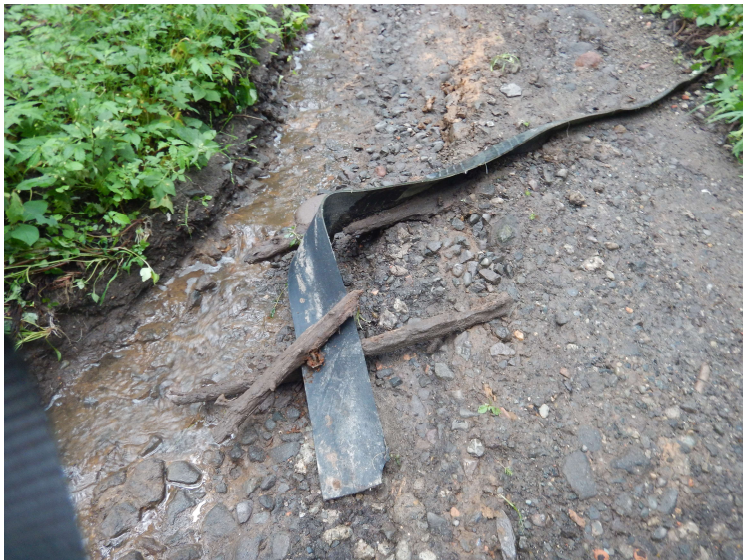
No.3 箕輪線 止水エース破損
