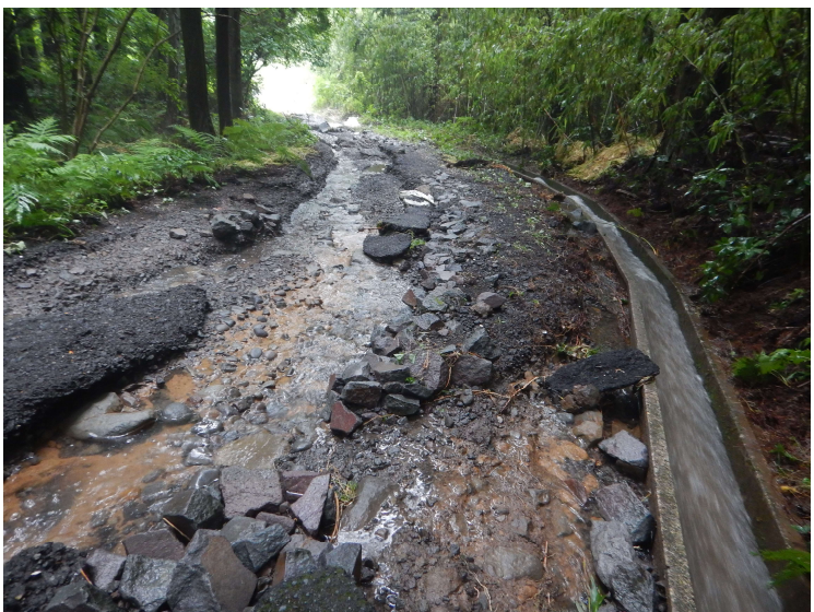
No.3 鹿野沢線 舗装陥没 写真上側から
