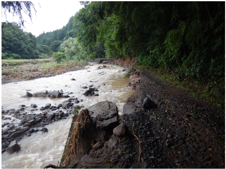
No.1 杉沢線 林道崩落 写真下側から
