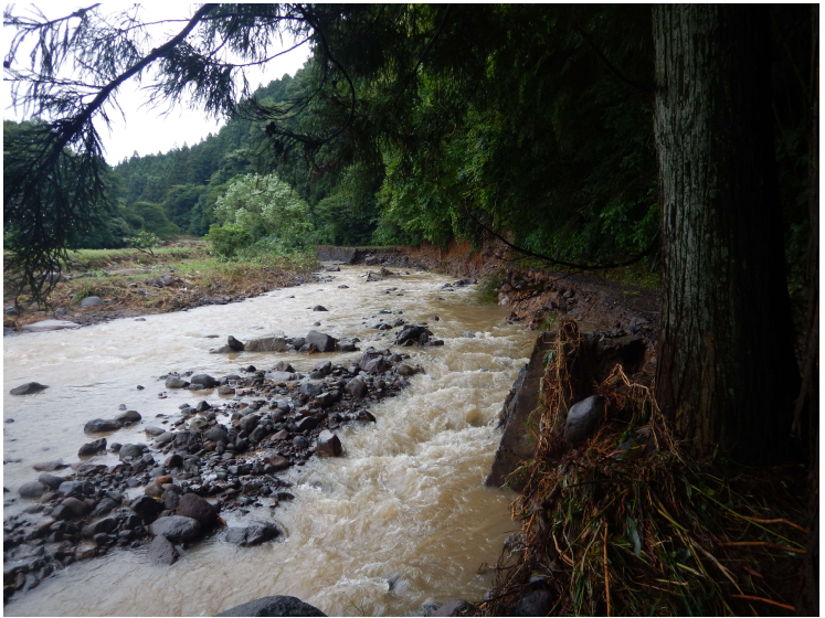
No.2 杉沢線 林道崩落 写真下側から
