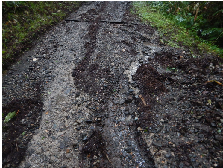
No.2 上小台線 砂利流出 写真下側から
