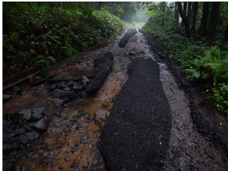
No.2 鹿野沢線 舗装陥没 写真下側から
