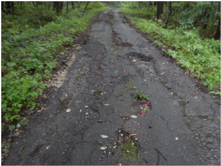
No.1 当山線 舗装陥没 写真下側から ..... ..... ..... ..... ..... ..... .....
