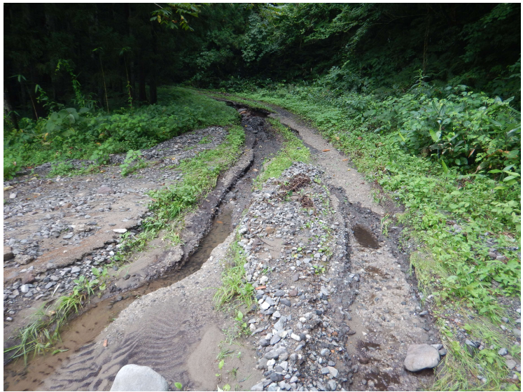
No.1 若林線 砂利流出 写真下側から
