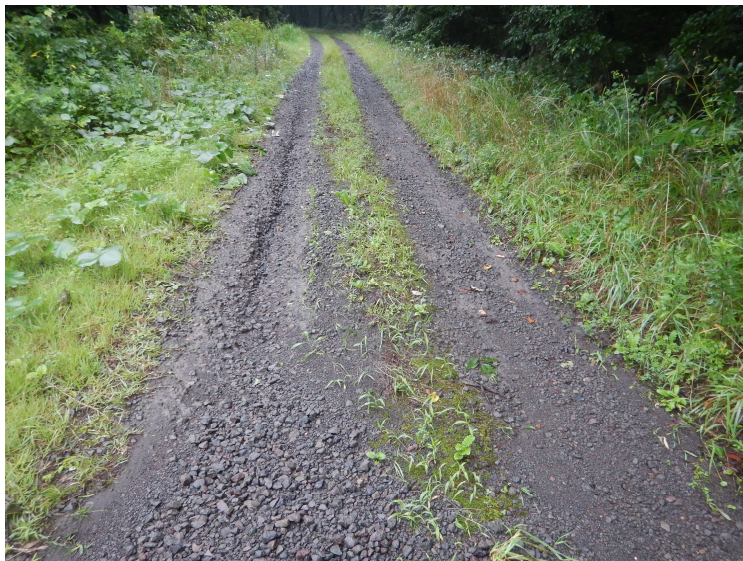
No.3 当山線 砂利流出 写真下側から ..... ..... ..... ..... ..... ..... .....
