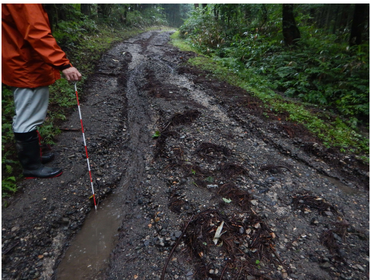
No.3 上小台線 砂利流出 写真下側から
