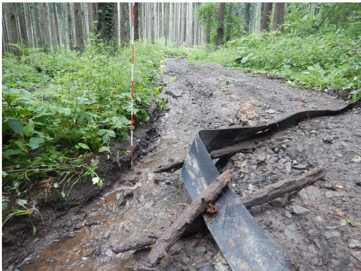
No.2 箕輪線 砂利流出 止水エース破損 写真下側から
