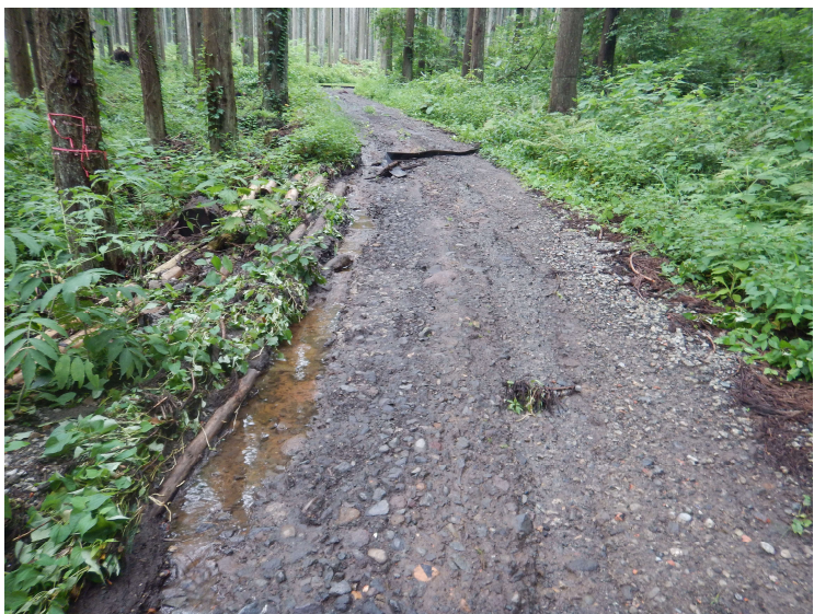
No.1 箕輪線 砂利流出 写真下側から
