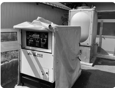
災害に備えた非常用発電機
