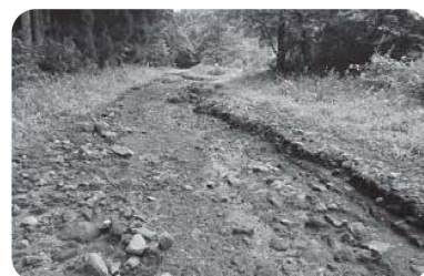
昨年7月の大雨災害で採石場から多量の水が流出したことで削られた道路 （令和6年8月29日撮影）
