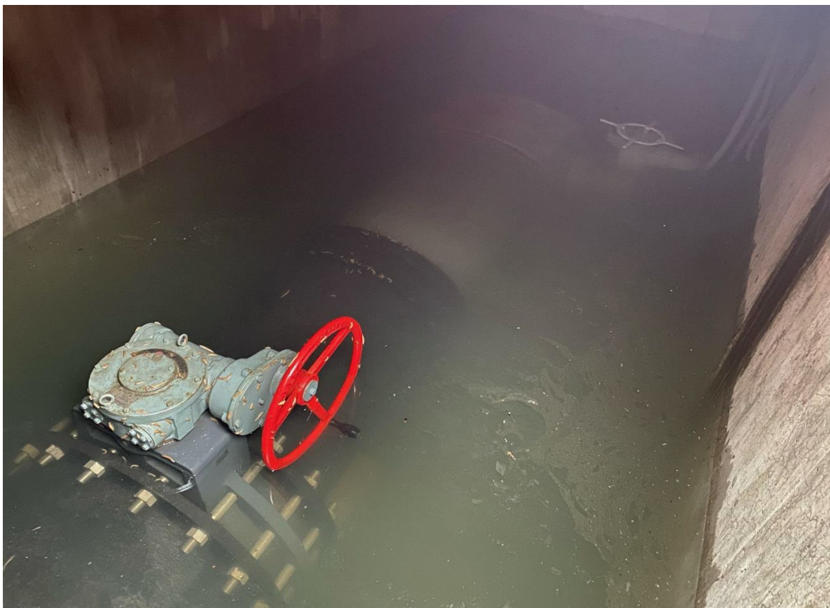
⑤左岸水槽ピット冠水
