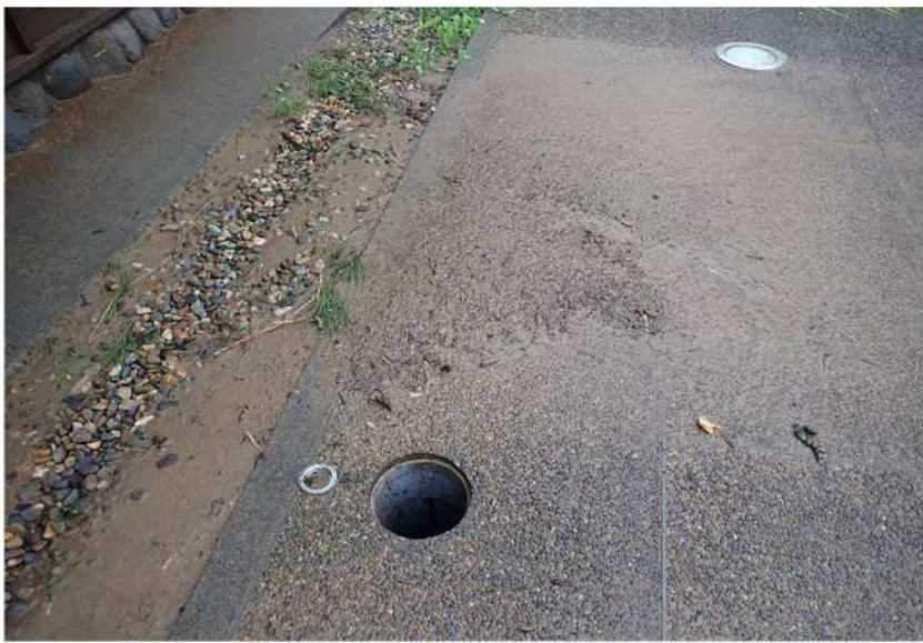
語りべの館 付帯設備破損
