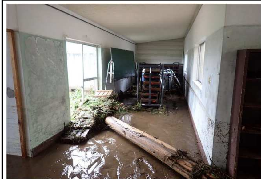
杉沢比山伝承館 体育館入口内部 流木侵入
