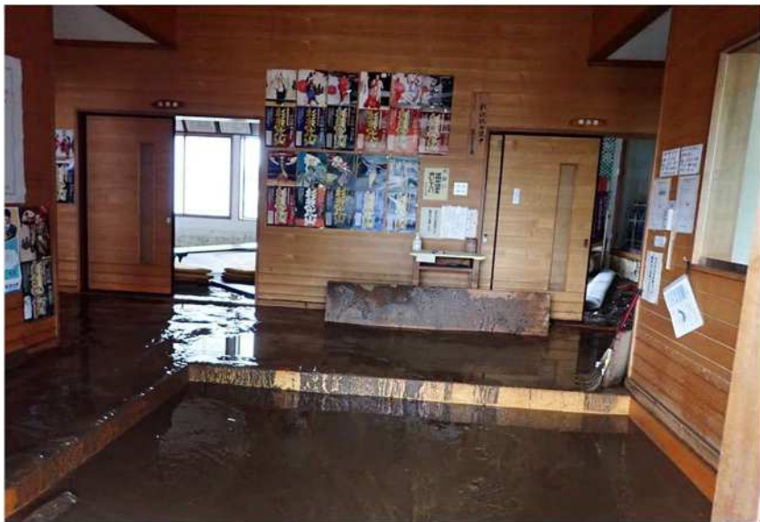
杉沢比山伝承館内部 床上浸水 土砂大量流入 内部各部屋同様の状況
