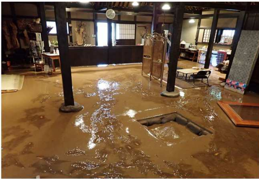
語りべの館 内部 土間部分 泥水流入
