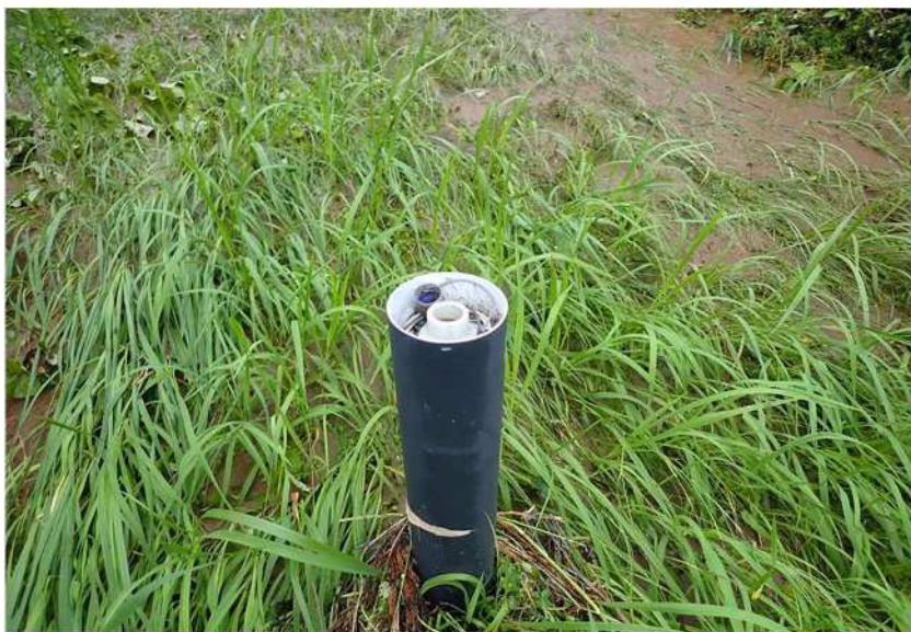
語りべの館 付帯設備破損 街灯部品脱落
