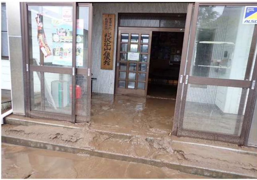
杉沢比山伝承館入口 土砂大量流入 停電状態、外水栓は使用可能
