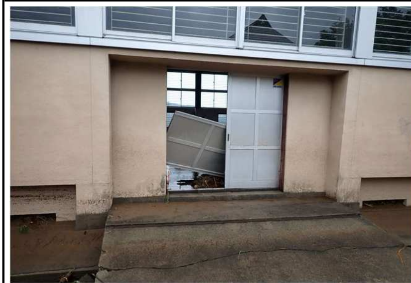
杉沢比山伝承館 体育館入口(南側) 扉破損
