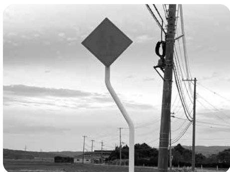
劣化した標識
