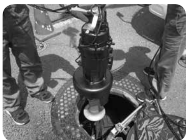
順次交換が進むマンホールポンプ
